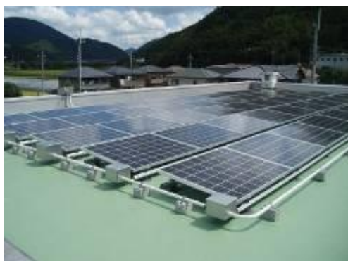
屋上を利用した太陽光発電（西紀小学校）
