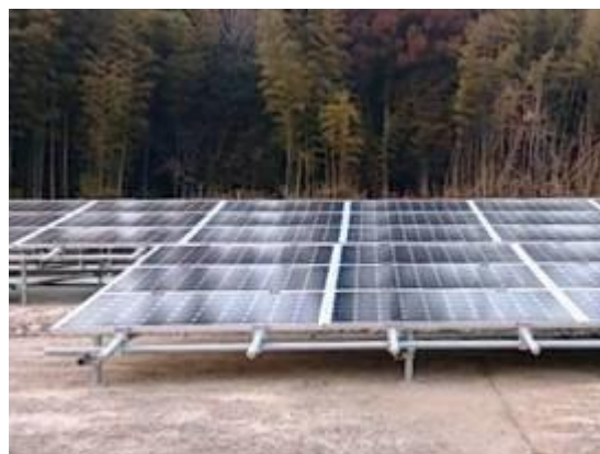
図表2-1 市内に設置された太陽光発電所7
