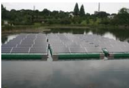
フロート式太陽光発電（小野市浄谷町浄谷新池）
