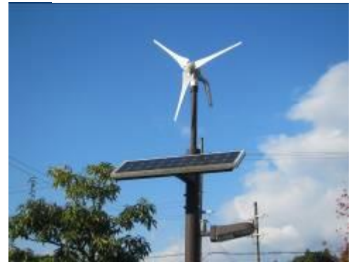
図表2-6 風力発電による照明
